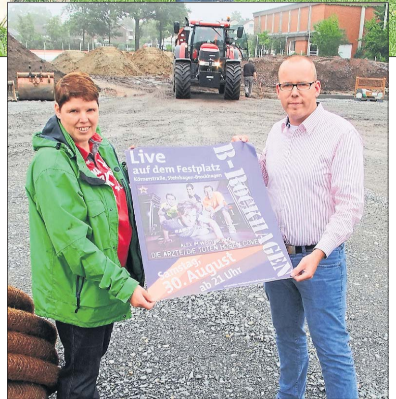
Noch beherrschen Baufahrzeuge das Bild auf dem neuen Festplatz in Brockhagen. Monika Tuxhorn und Stephan Kaiser sind zuversichtlich, dass zum Dorfgemeinschaftsfest alles fertig ist. Foto: Hagemann
